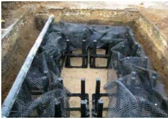
Positionnement des caissons entourés d'une géogrille. La canalisation d'eau est intégrée à l'installation (voir étude de cas n°9 p. 38).
